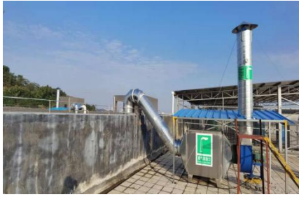
焊接、灌胶、钢网版清洗废气设施
