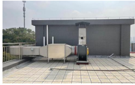
食堂油烟废气治理设施
